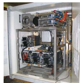
Brennstoffzellencontainer Foto: HFCS
