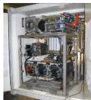
Brennstoffzellencontainer Foto: HFCS
